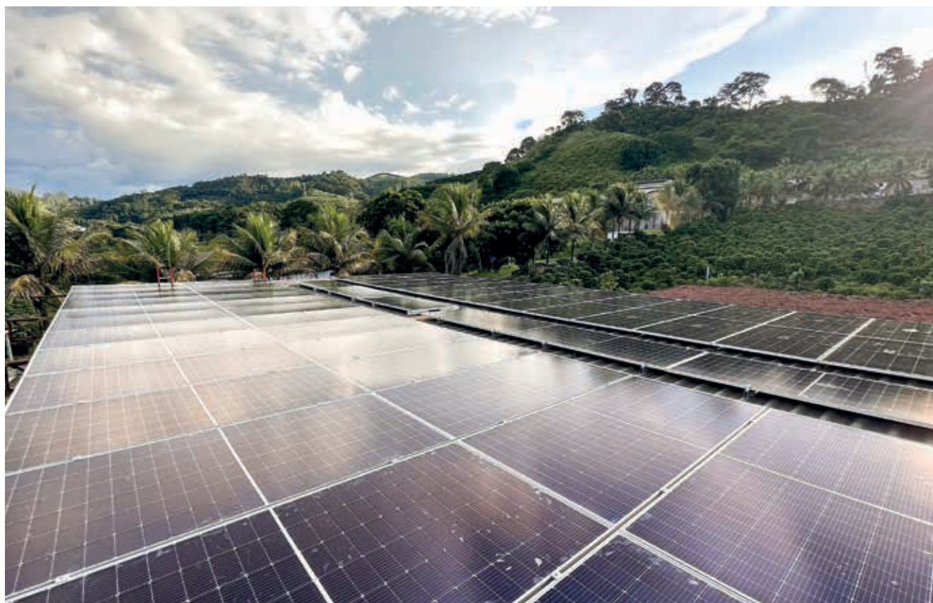
No primeiro mês após a instalação das placas, o consumidor já observa redução na conta de luz
