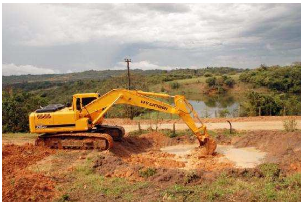
Figura 7-4: Implantação de uma bacia de retenção às margens de uma estrada vicinal
