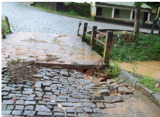
Figura 4-20: Março/2009. Ponte sobre o Córrego Santa Marta. Imagem pós-inundação.
