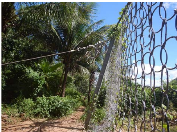
Figura 12. Rede flexível de impacto, projetada para conter a trajetória de eventuais blocos que possam se desprender do maciço rochoso ou remobilizar da encosta. Setor ES_MIMOSOD_SR_01_CPRM.
