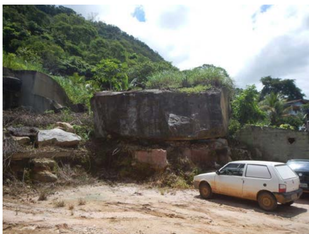
Figura 18. Lasca de rocha, com espessura de aproximadamente 1,5 metros em cima do que restou da construção do Posto de Saúde. Setor ES_MIMOSOD_SR_03_CPRM.
