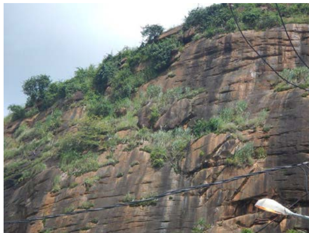
Figura 17. Raízes de vegetação rasteira penetrando as descontinuidades da rocha. Setor ES_MIMOSOD_SR_16_CPRM.
