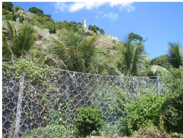
Figura 13. Rede flexível de impacto, projetada para conter a trajetória de eventuais blocos que possam se desprender do maciço rochoso ou remobilizar da encosta. Setor ES_MIMOSOD_SR_01_CPRM.
