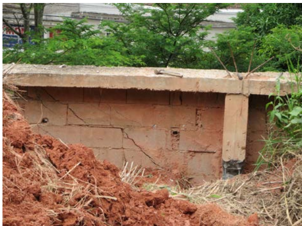
Figura 22. Muro trincado devido ao peso do aterro no local, podendo vir a desmoronar. Setor ES_MIMOSOD_SR_08_CPRM.
