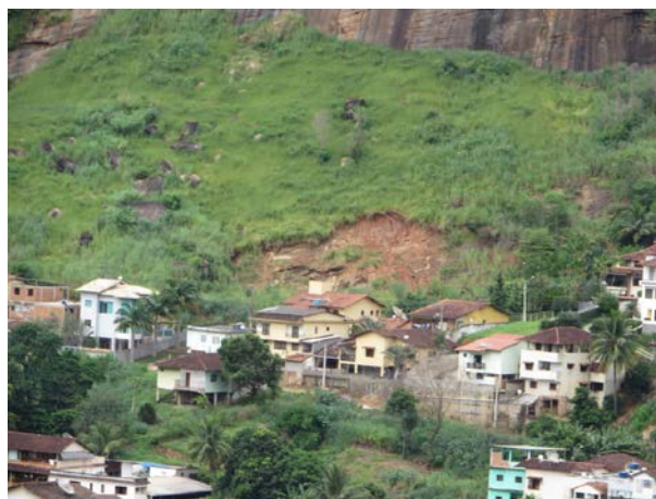
Figura 25. Deslizamento de massa no setor de risco ES_MIMOSOD_SR_01_CPRM, onde apesar do solo não ter afetado nenhuma residência, o avanço do processo de deslizamento ou erosão pode instabilizar blocos de rocha presentes na encosta.
