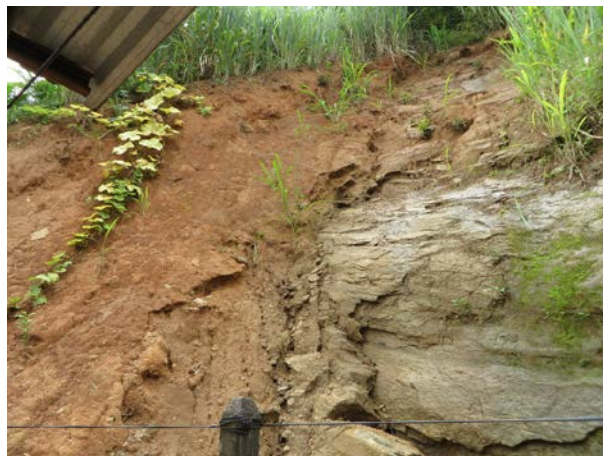
Figura 23. Camada de solo de pouca espessura em contato direto com a rocha, propiciando a instabilidade do talude no setor de risco ES_MIMOSOD_SR_07_CPRM.
