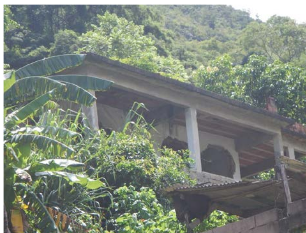
Figura 19. Parede de residência parcialmente destruída por bloco rochoso. Setor ES_MIMOSOD_SR_03_CPRM.
