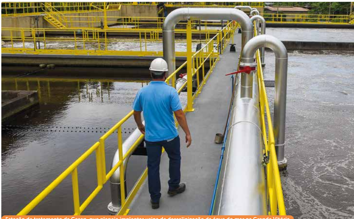
Estação de tratamento da Cesan, que planeja implantar usina de dessalinização da água do mar na Grande Vitória
